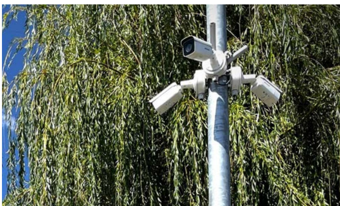
Rozbudowa monitoringu wizyjnego w gminie – na parkingu przy Bukowiance. Liczba zamontowanych kamer: 3. Koszt zadania: 5814 zł.
