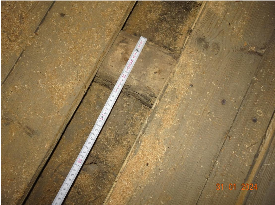
Fot.6. Wnętrze kościoła, istniejąca podłoga drewniana – widok na legar
